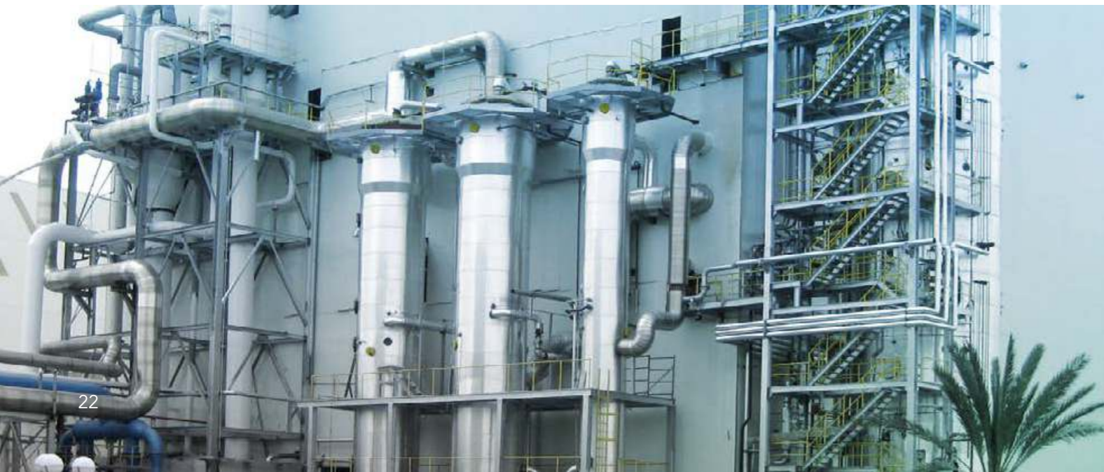
Image source: BMA Braunschweigische Maschinenbauanstalt AG
